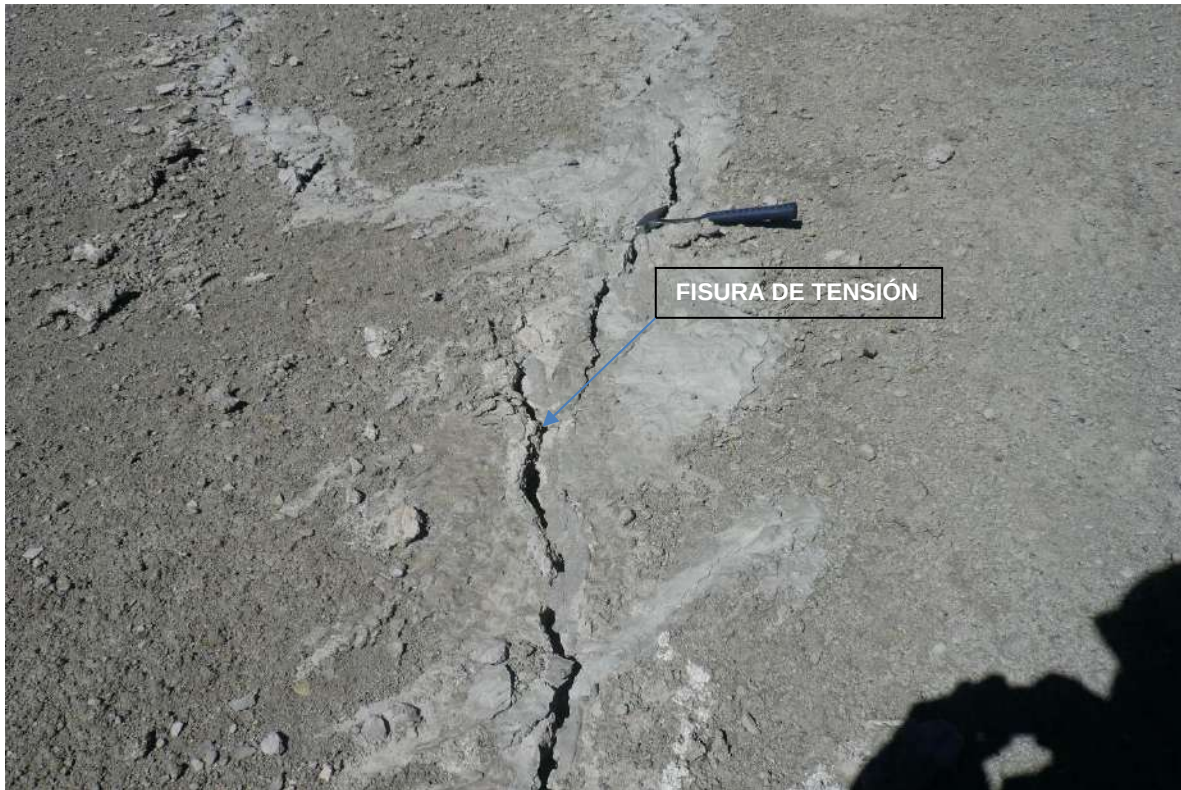
FIGURA 7-2 FISURA DE TENSION SECTOR RETALUDEO.
