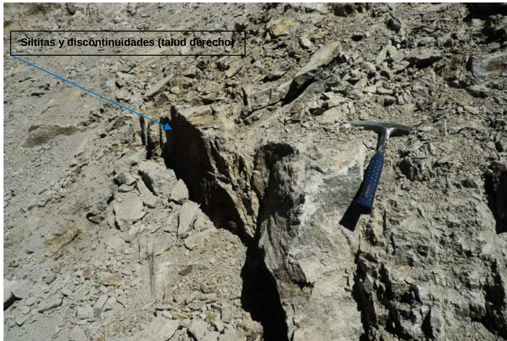
FIGURA 7-7 SILTITAS Y DISCONTINUIDADES (TALUD DERECHO) EJES 9-11.
