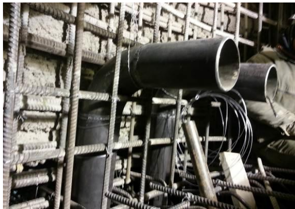
Tubo d=4" vertical para medición de equilibrio de presiones en Pozo de Compuertas
