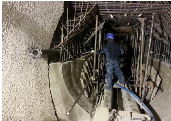
Tubo d=4" laterales para medición de niveles en Pozo de Compuertas
